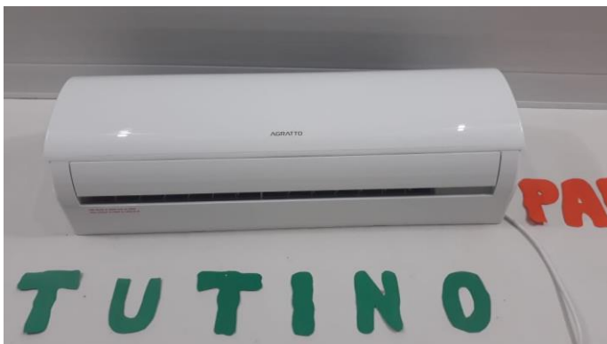
SALA MULTIUSO 02 - AR CONDICIONADO AGRATO 18.000 BTUS
